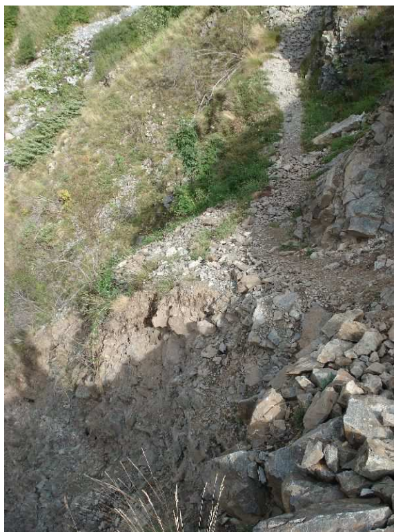
Sentier dangereux en bord de ravin
