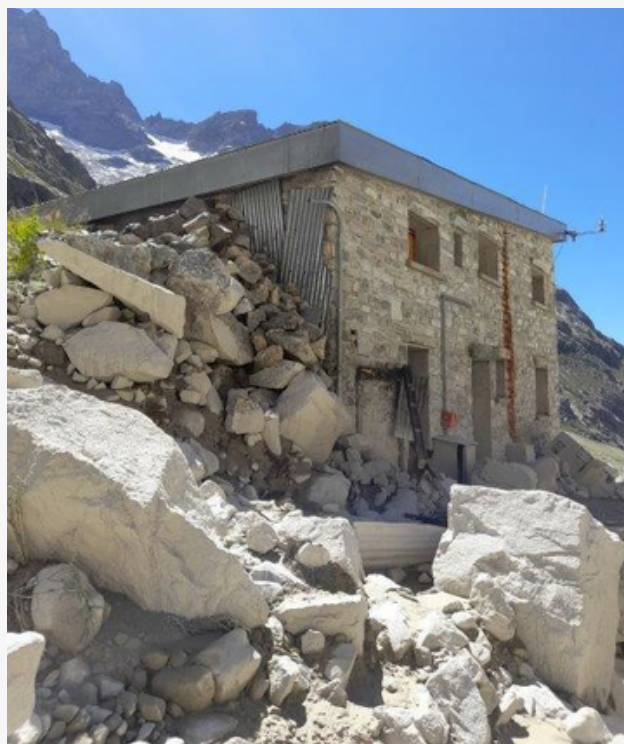
Figure 7: Façade ouest du refuge endommagé par la crue torrentielle. ONF RTM 38.
