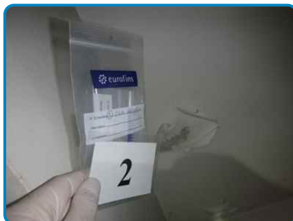
Prélèvement n° 2 : Plafond Plâtre (dans 1er étage Coin cuisine)
