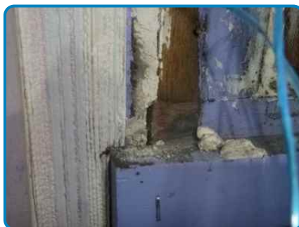
Absence d'étanchéité dormant / maçonnerie
