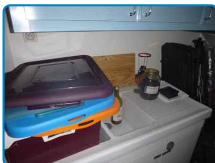
Absence de faïence dans la cuisine
