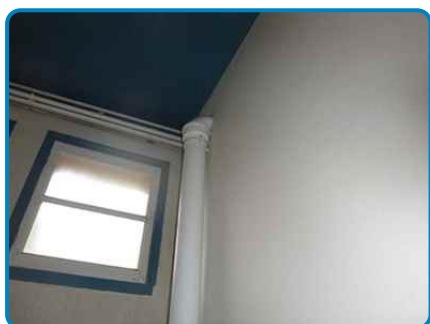
Evacuation des eaux vannes fontes (vue au rdc)
