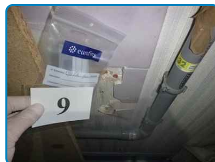
Prélèvement n° 9 : Mur Colle de faïence (dans 1er étage Salle de bains)
